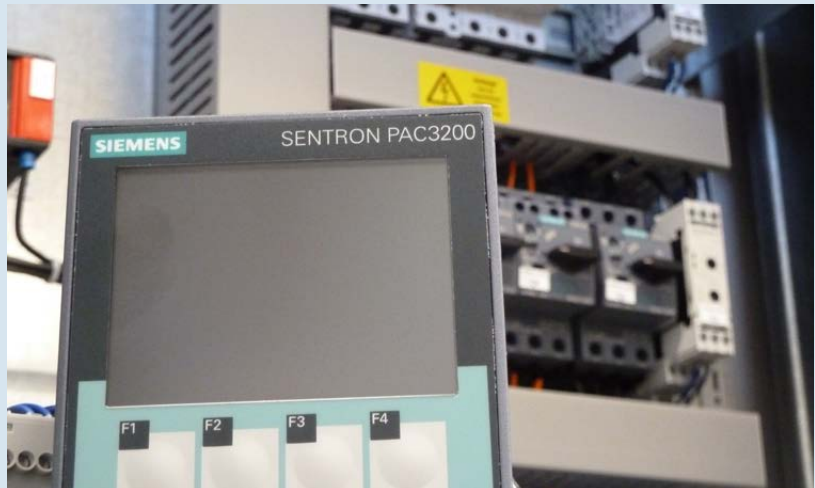
Messtechnik und IT-Netzwerk zur Energiedatenerfassung
