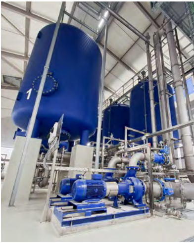
Die im Sanierungswasserwerk Barchfeld vorhandene Filteranlage wurde zur Manganaufbereitung umgebaut.
